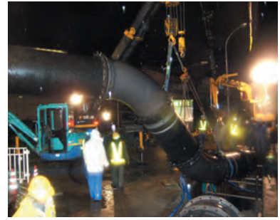
水道施設の修繕体制
