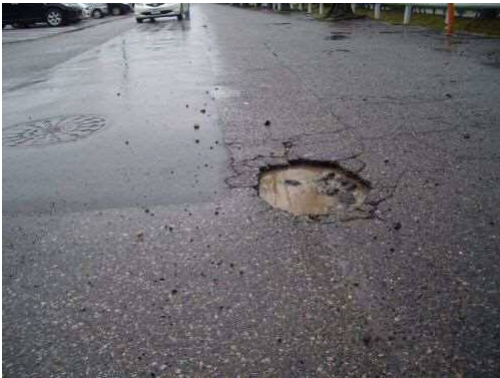
①道路損傷発見
