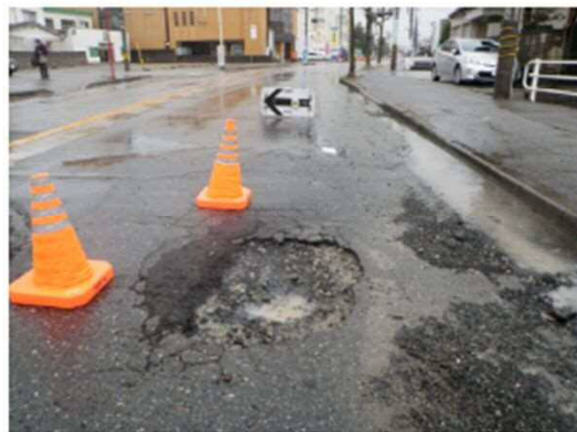
はく離の様子
